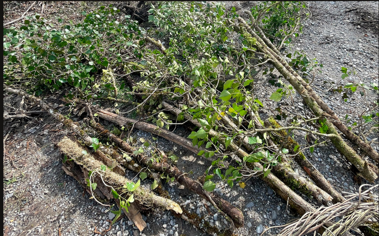
Sélection des matériaux pour l'installation
